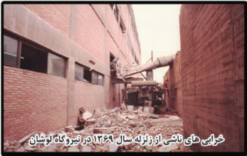
خرابی‌های ناشی از زلزله سال ۱۳۶۹ در نیروگاه لوشان
